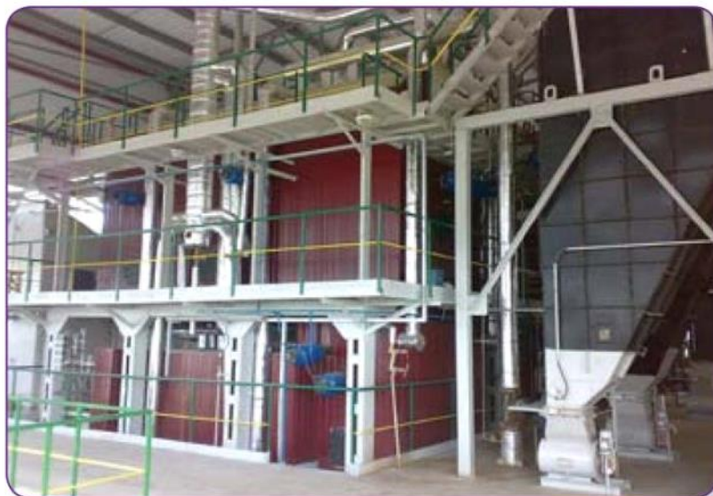
Котельная, г. Кировоград
